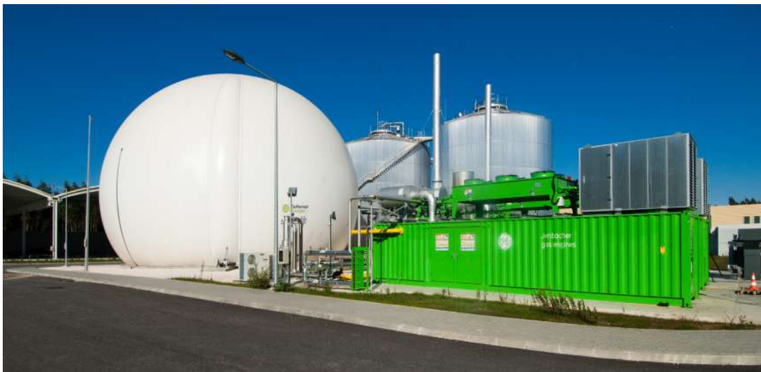
Figura 22. Motor de biogás e gasómetro
