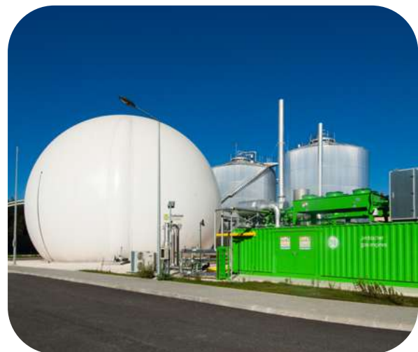
Figura 22. Motor de biogás e gasómetro
